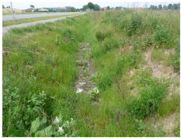
Abb. 6: Vermüllter Graben an der Borringhauser Straße.
