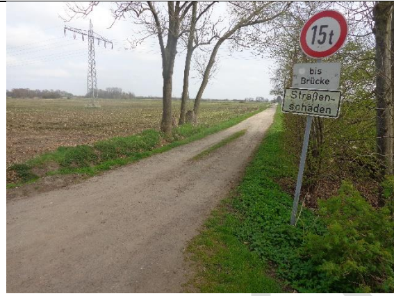
Abb.: Straßenschäden auf Nebenstraße
